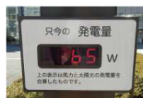
▲発電量表示パネル
