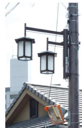
▲電柱共架式照明
