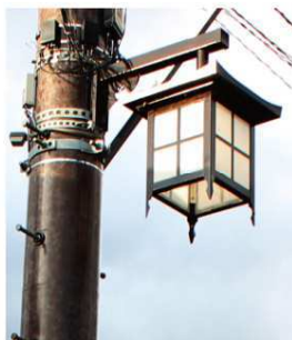
▲電柱共架式照明
