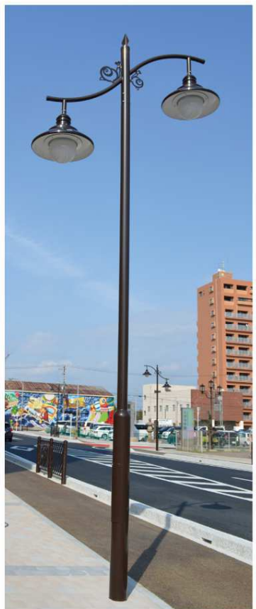
■ 歩道用照明器具：特 HS-487 型 ・光源 : LED (白色) ・器具高 : 4.2m/5.0m
