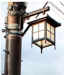
▲電柱共架式照明
